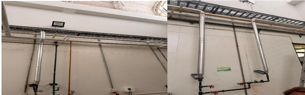
Figura 41. Tuberías y válvulas lugar de desarrollo Berástegui
