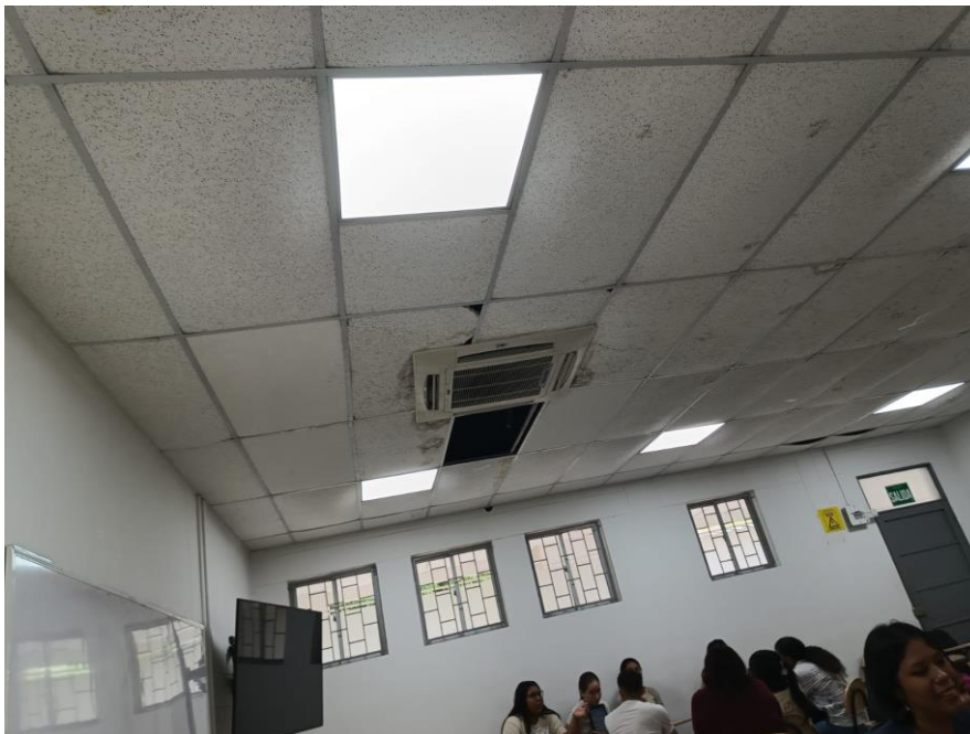
Facultad de educación, cielo raso en mal estado.
