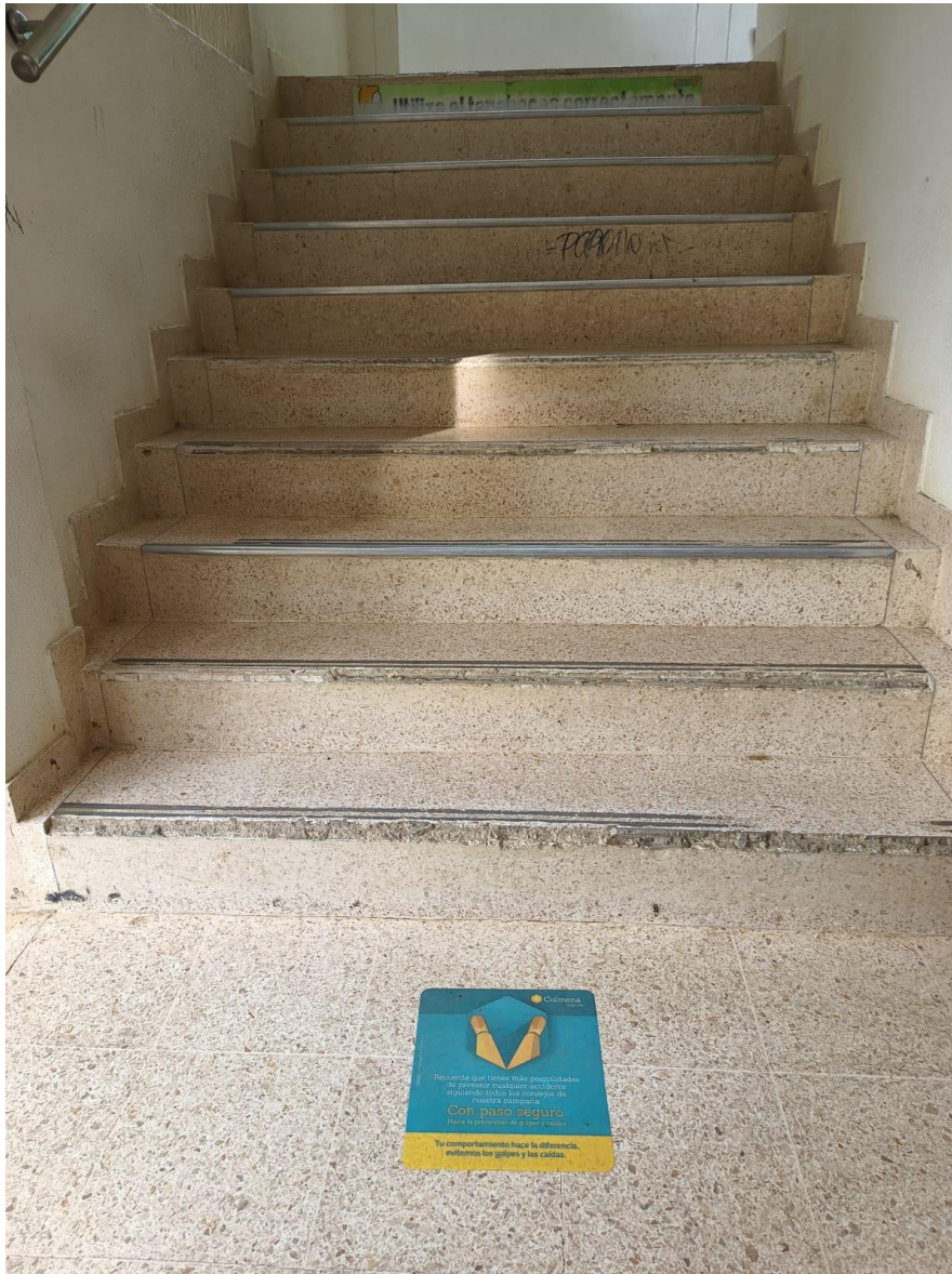
Escaleras edificio de informática en mal estado
