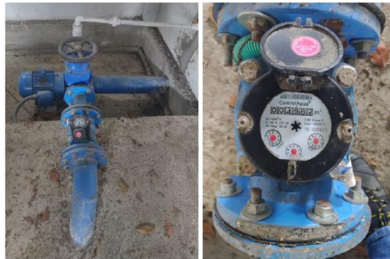
Figura 1. Medidor de caudal en funcionamiento
