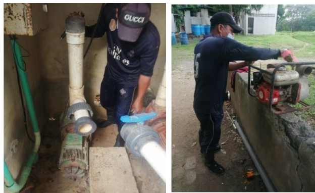
Figura 2. Mantenimiento preventivo mensual de los estanques y las motobombas utilizadas en la captación y recirculación
